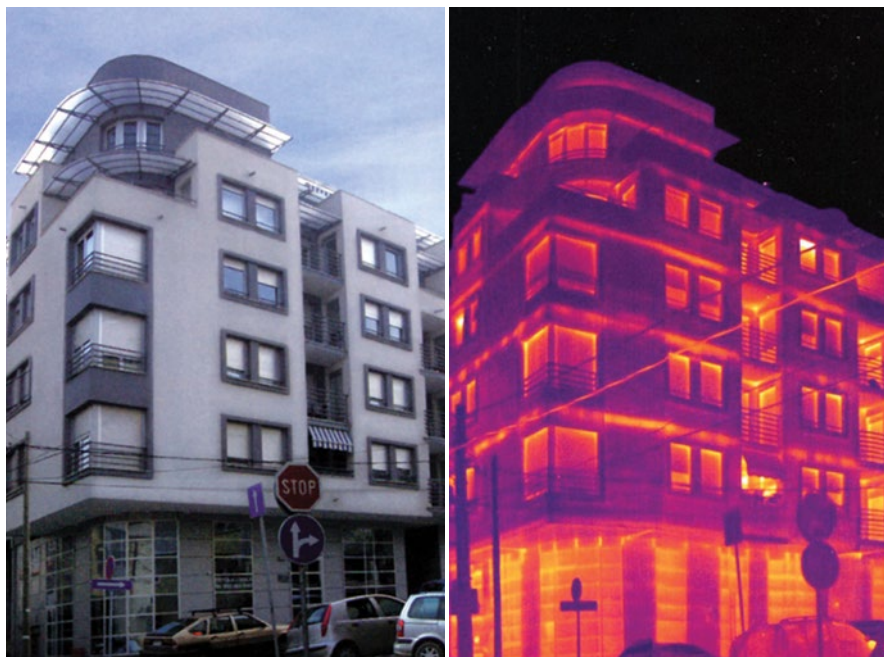
„Videti energiju“ (Seeing energy) - knjiga autora Milice Jovanović Popović i Dušana Ignjatovića sa termovizijom snimkom (desno) dobro i loše termički izolovanih mesta na fasadi građevinskog objekta.
