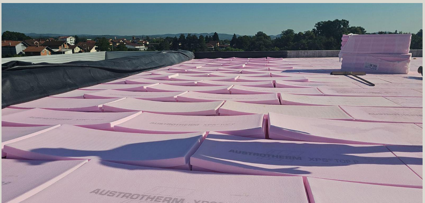
Leva polovina fotografije (snimljena u leto ): Posledice postavljanja hidroizolacione membrane iznad XPS-a = deformacija XPS-a!
