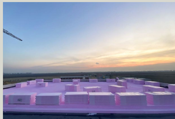
Trafo stanica “EXPO 2027” Izvođač: Beeroofing d.o.o. Beograd
